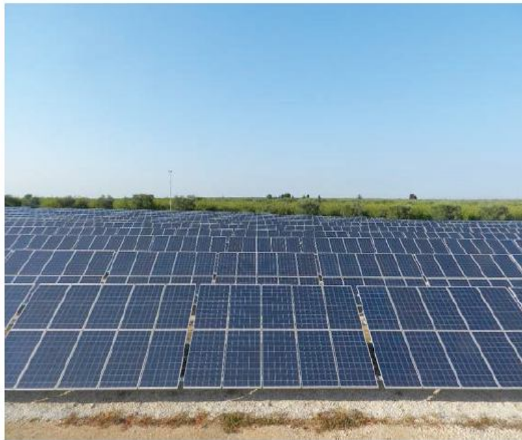
Impianto fotovoltaico ad Acquaviva delle Fonti
